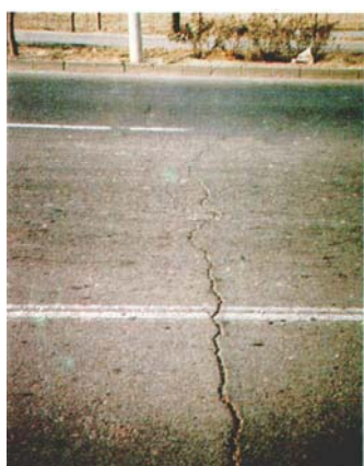
в – поперечная трещина
