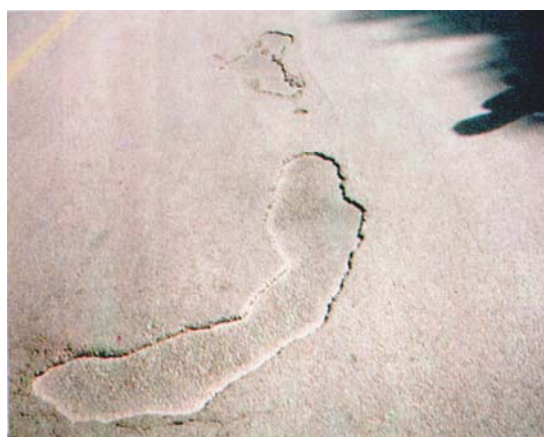
ж – отслаивание верхнего слоя
