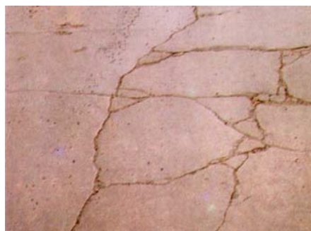
г – сетка трещин старения
