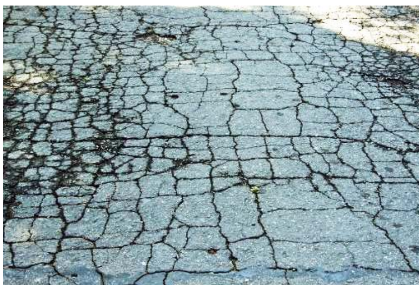
Рис. 7.13. Сетка усталостных трещин
